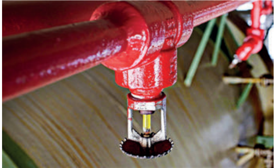
↑ Los rociadores son elementos muy fiables y efectivos
