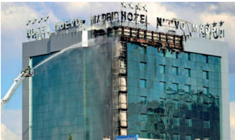
↑ El hotel Nuevo Madrid fue afectado por un incendio en altura que se propagó por la fachada
